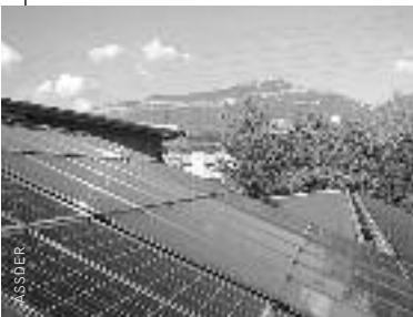
Chambéry : 1966 m 2 installés.
