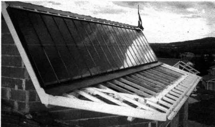
Installation des capteurs.
