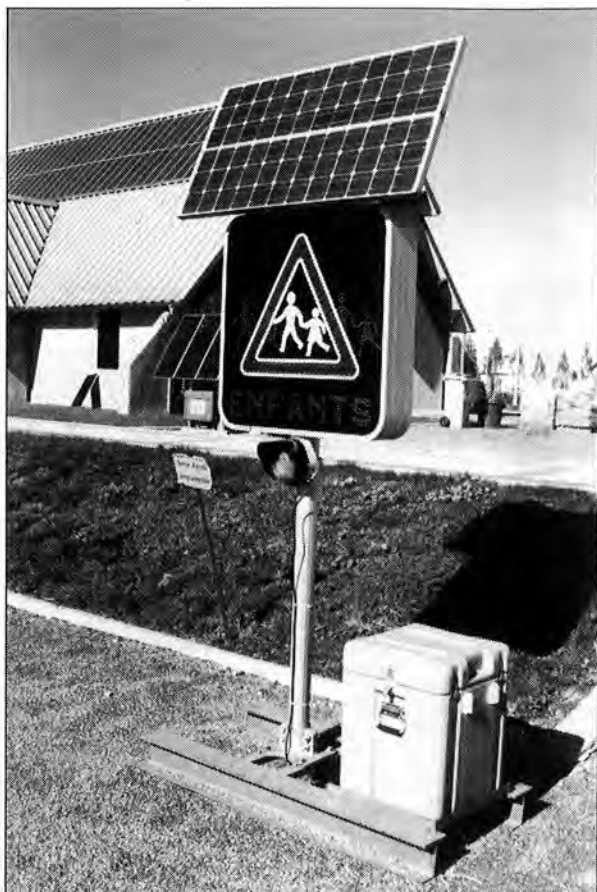
Panneau de signalisation clignotant évitant un raccordement coûteux.
