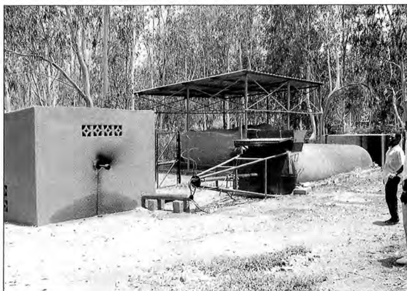
Installation de bio-gaz. Sous le hangar, on peut voir le ballon de réserve qui se gonfle ou se dégonfle selon l'usage et la production. (photo J.Caclin)
