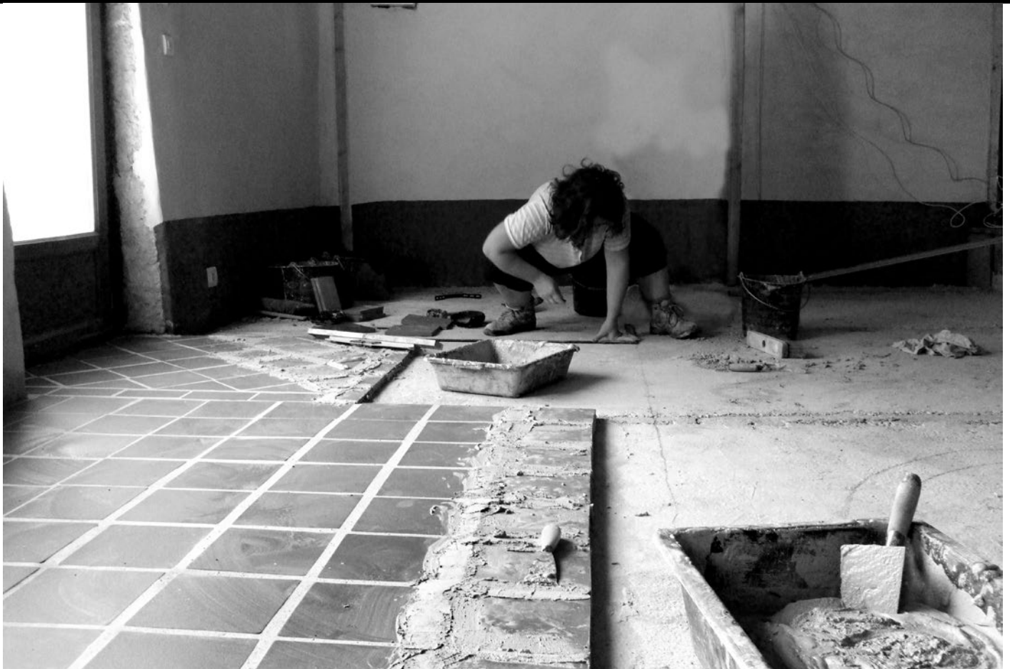
▲ L'intérieur du bâtiment est rénové de manière autonome, en utilisant les savoir-faire présents au sein du collectif ainsi que des chantiers ouverts.
