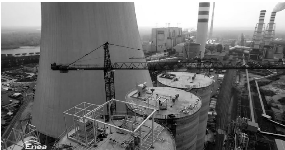
Kozienice (Pologne) : centrale à charbon
